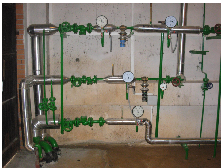
Слика 4.9 Хидрауличка инсталација за редукцију притиска
