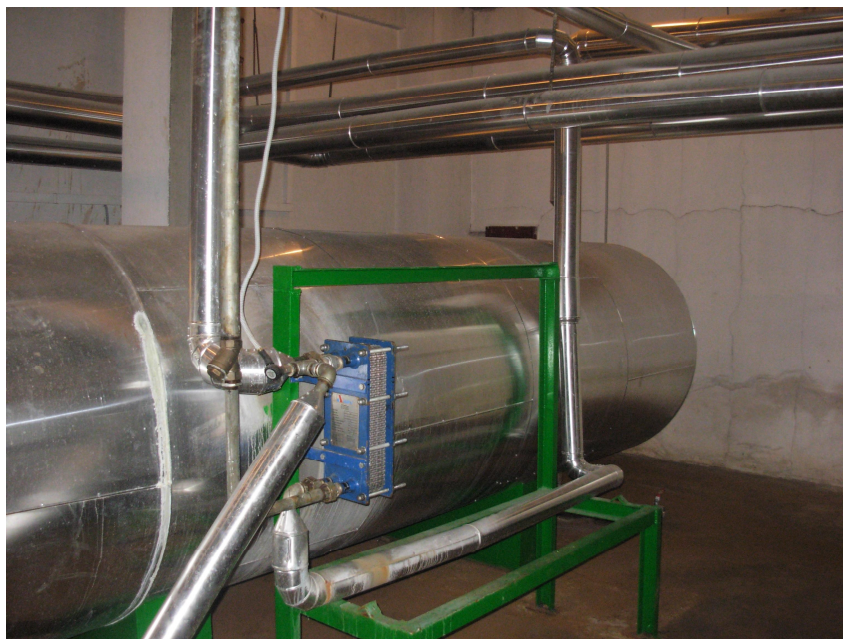
Слика 4.13 Плочасти измењивач топлоте за загревање санитарне топле воде и резервоар
